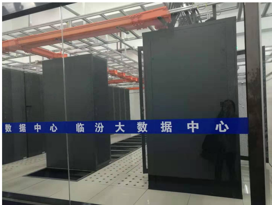
附图 2：基层医疗卫生机构管理信息化建设项目硬件设备现场
